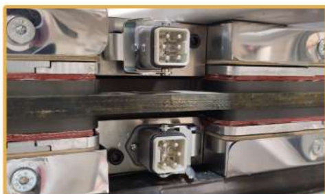
کانکشن کابل اتصال اتوها روی دستگاه
